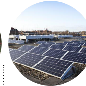
Dak met zonnepanelen
