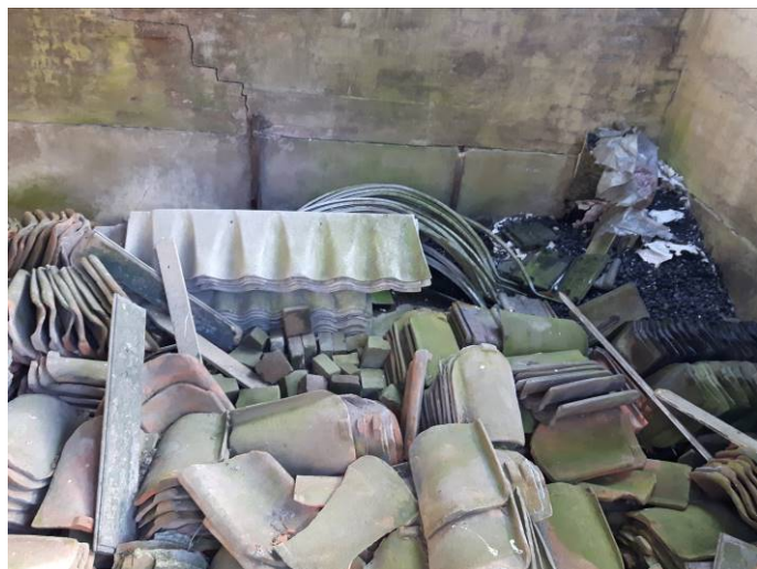
Foto 7: Asbesthoudend materiaal in opstal
