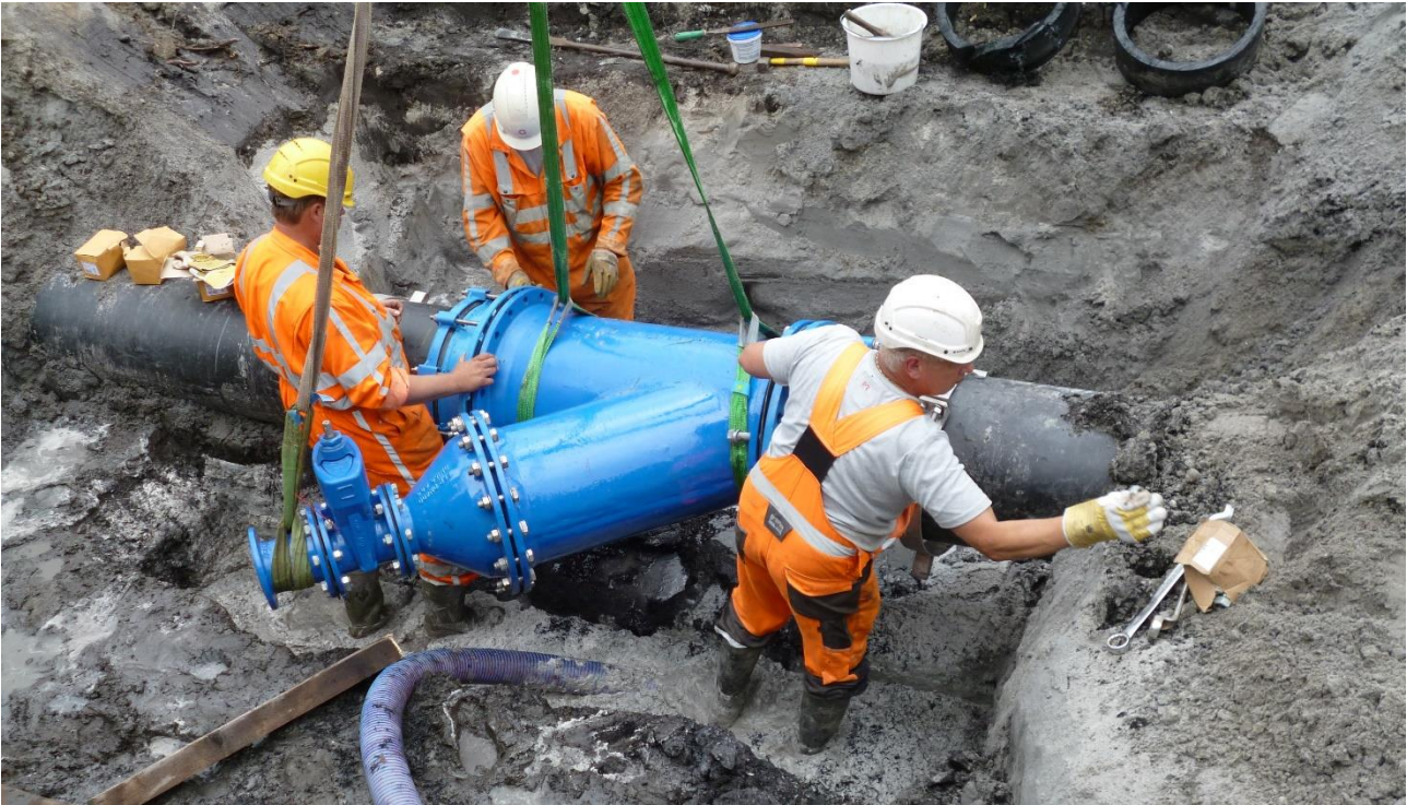
Figuur 15 – Aansluiting van een persleiding bij Kwadijk. (Bron: hoogheemraadschap Hollands Noorderkwartier)
