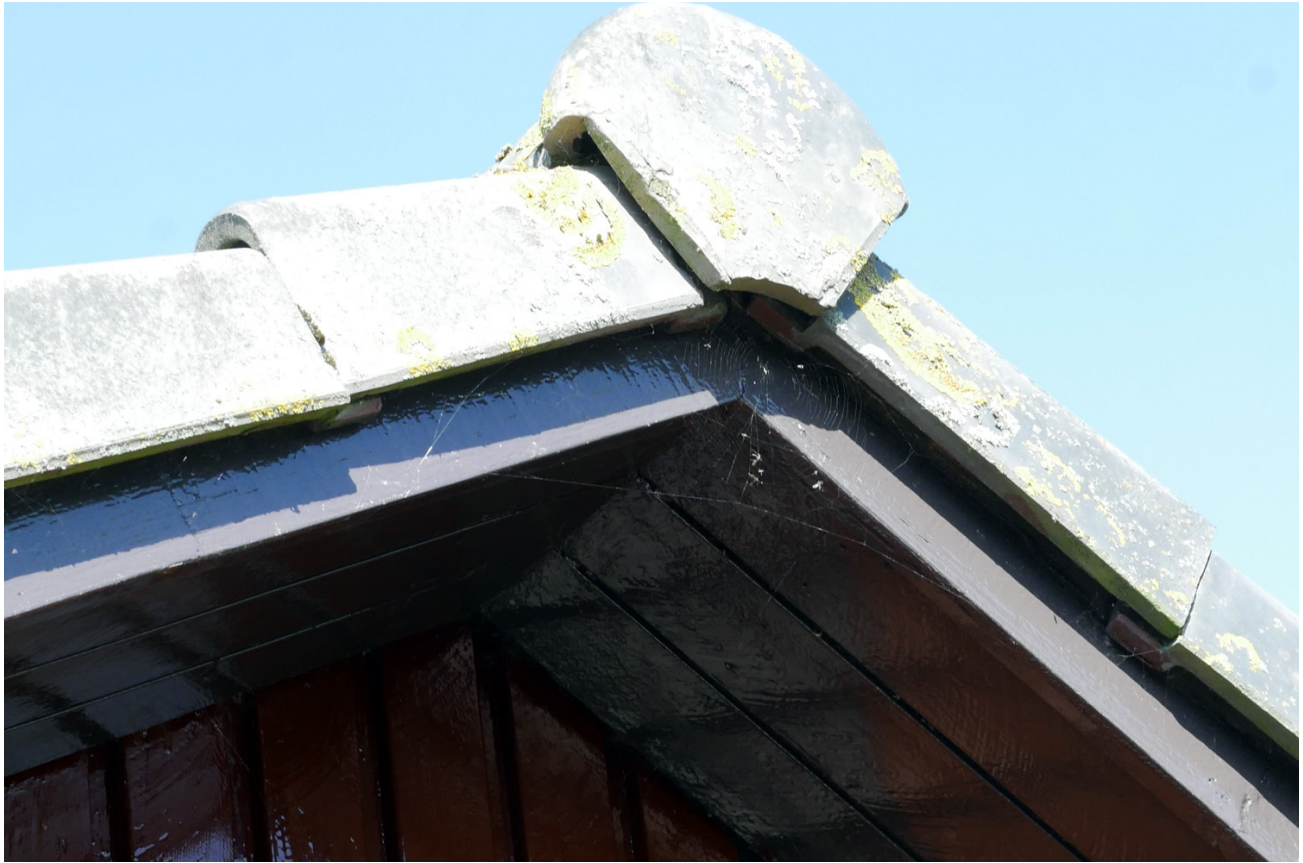
Afb.4: Nok op de zuidzijde van het pand. Dikke verflaag en spinnenrag.
