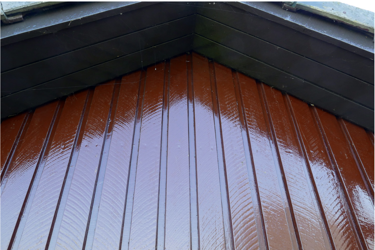
Afb.1: Gevel aan beide zijden bedekt met houten bekleding welke dik in de verf staat. Weinig tot geen grip voor aanvliegende vleermuizen.
