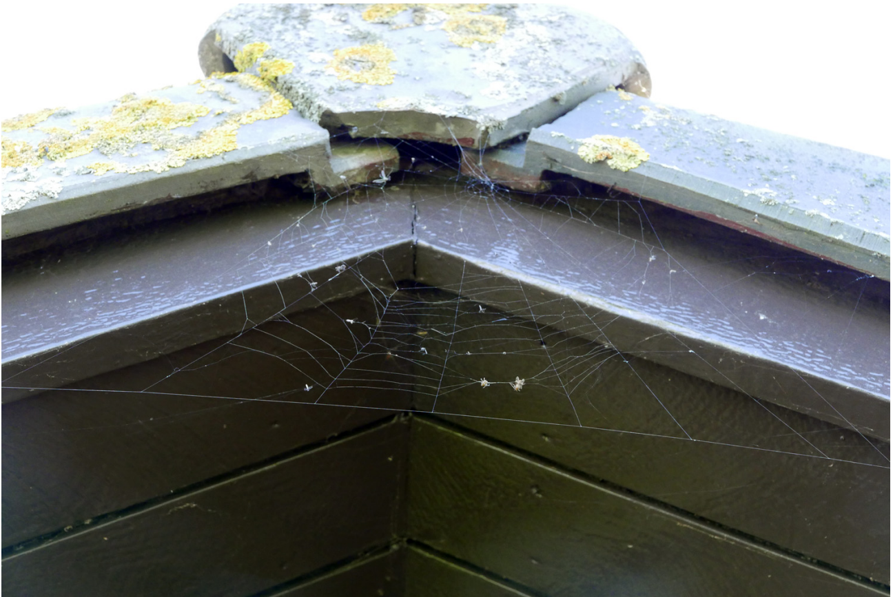
Afb.3: Nok op de noordzijde van het pand. Dikke verflaag en spinnenrag.
