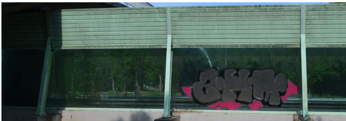
Geluidsscherm aan oostzijde A7 bij voetgangersbrug Volgerweg
